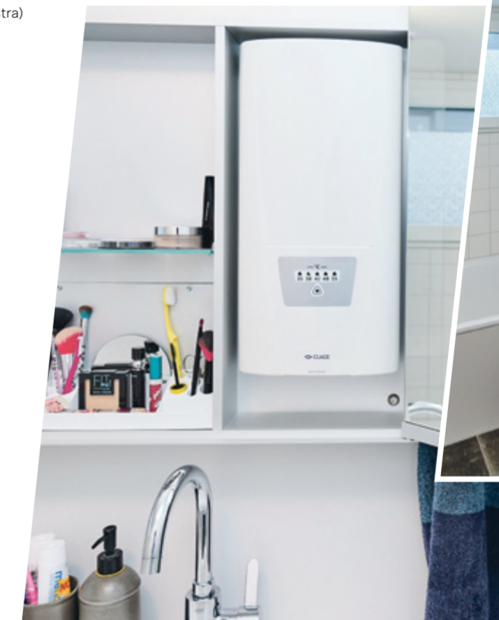
Il sistema di risparmio, nascosto dietro la controparete, riscalda l'acqua con il calore generato dalla ventilazione.
