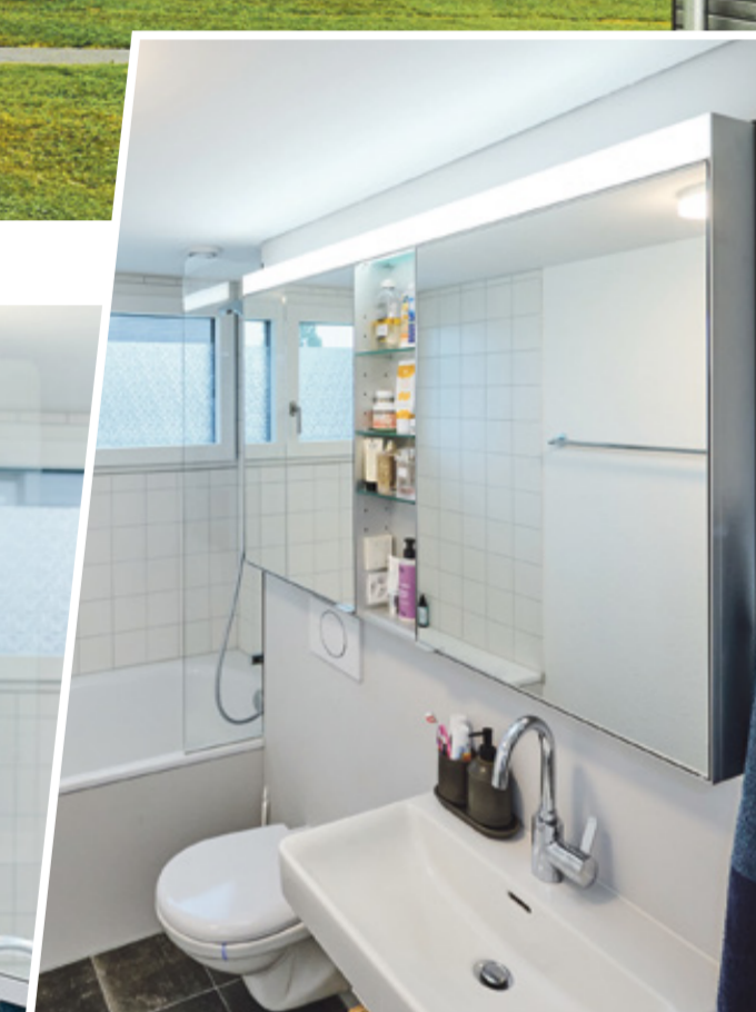
Das Sparsystem steckt hinter der Vorwand. Es wärmt das Wasser mit der Abwärme aus der Lüftung.
